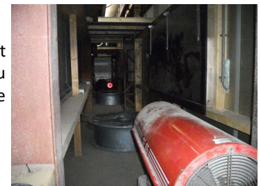
Canon à air chaud dans le couloir technique
